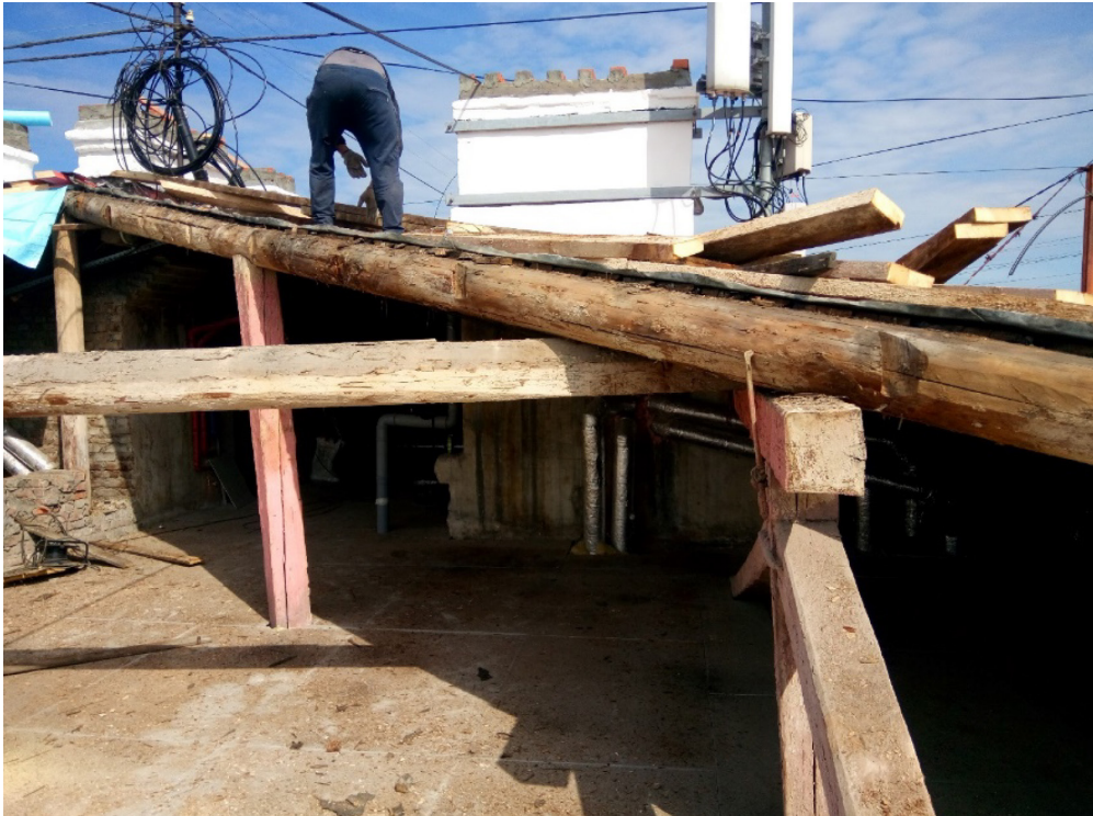
Рис. 4.7. Соединение скобами бревен стропильной системы исторического здания в Санкт-Петербурге. Автор фото Ю. И. Тилинин, 2020 г.
