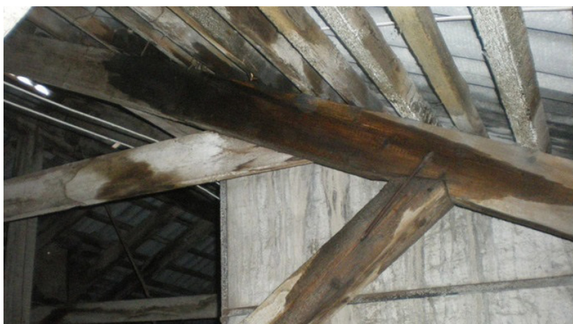
Рис. 4.17. Работоспособное состояние стропил с грибковыми поражениями. Автор фото Д. А. Животов, 2019 г.
